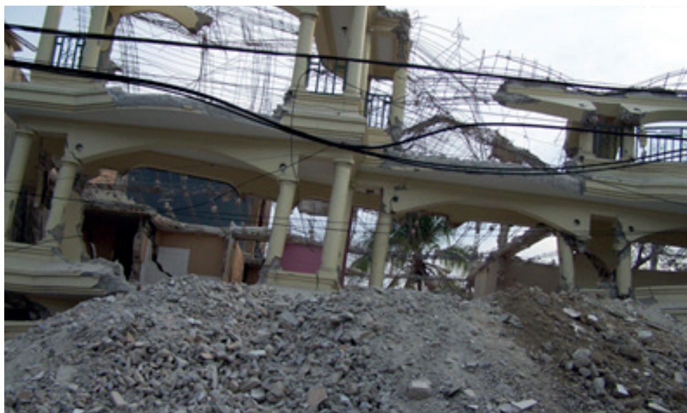
Immeuble effondré à Port-au-Prince, 2010 ▲
